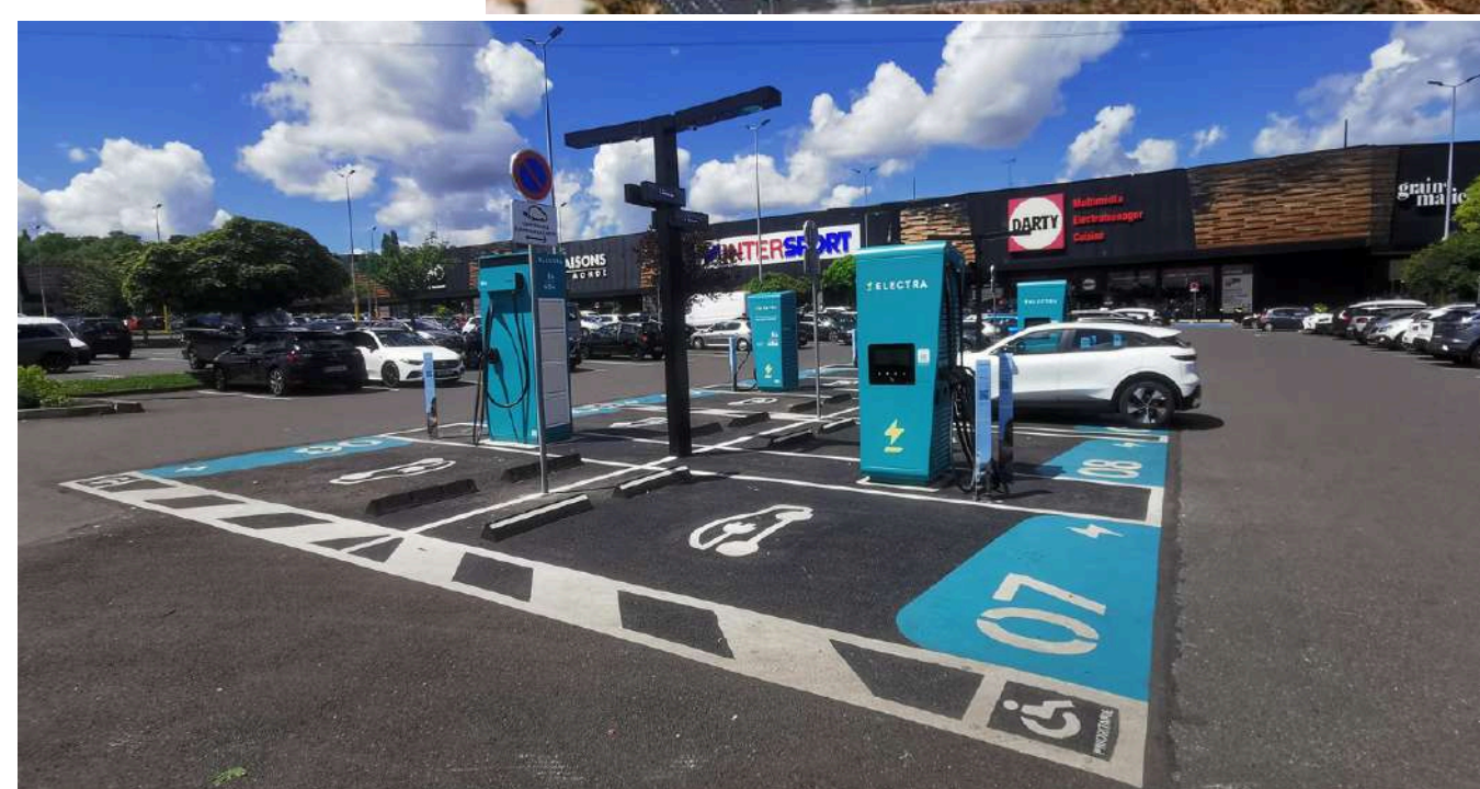
Station de recharge électrique installée au parking du centre commercial de Villebon @M.MBOUP
