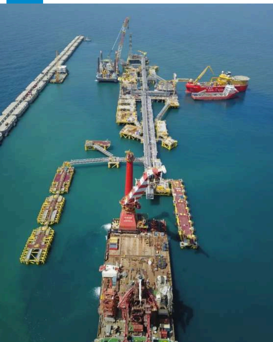
Les installations de GTA à Saint - Louis
